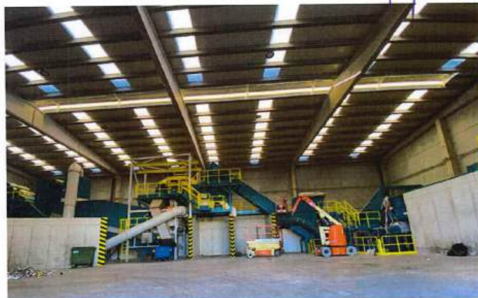
Figura 25 - Central de CDR - Visão Interior
